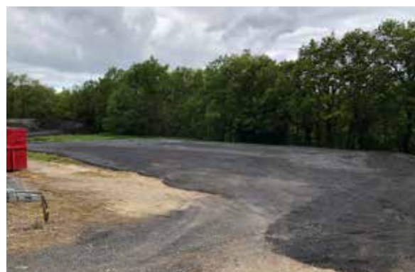
Lieu d'implantation de la déchetterie mobile.
